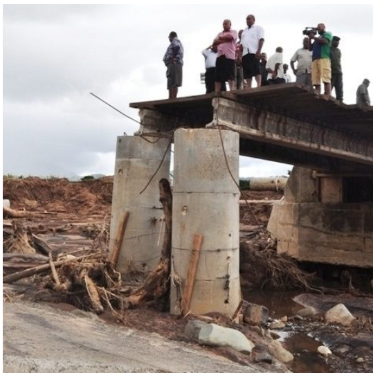
Damaged Moto bridge in Ba following March 2012 floods Pont endommagé à Ba par les inondations de Mars 2012
