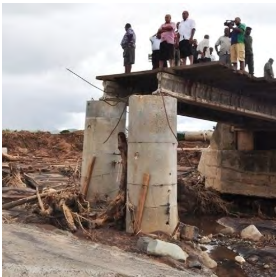
Damaged Moto bridge in Ba following March 2012 floods Pont endommagé à Ba par les inondations de Mars 2012
