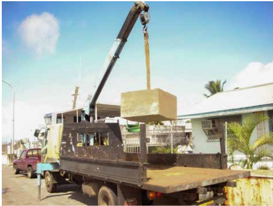
Photographie 2 : gros bloc de béton soulevé par une grue en vue de son mouillage.
