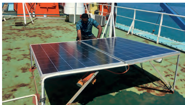
Panneaux photovoltaïques installés sur un navire.
