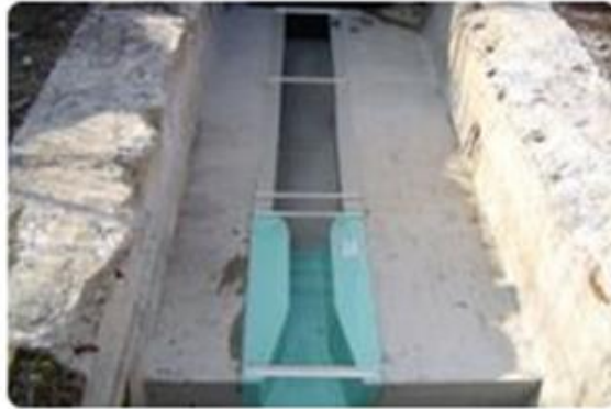
Figure 11 Canal venturi (seuil contracté), source Société Endress Hauser (8)
